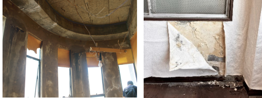
図3 コンクリートのひび割れの様子 図4 塗装がはがれている様子
